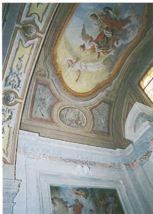
24, 25 - La volta della cappella di San Francesco Saverio prima e dopo i restauri.
